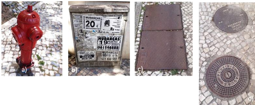
Figura A3. 4 - Infraestruturas técnicas, a) boca de incêndio; b) rede de distribuição de energia elétrica; c) rede de telecomunicações; d) drenagem de águas pluviais e drenagem de águas residuais; outros - rede de gás e abastecimento de água, (Fonte: de autor) julho 2022.
