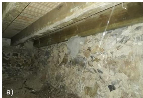
Figura 4.12 - Aspeto da fundação onde é visível a desagregação (Fonte: de autor), junho 2022.
