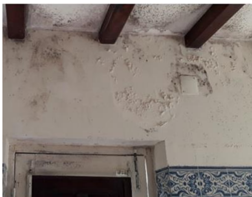
Figura 4.17 - Manchas devido a infiltrações na cobertura (Fonte: de autor), junho 2022.
