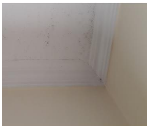
Figura 4.18 - Condensações devido a falta de ventilação, (Fonte: de autor) junho 2022.
