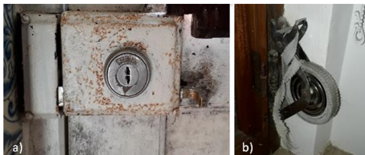
Figura 4.19 - Alguns dos acessórios degradados; a) Fechaduras, b) Bobina de enrolamento dos estores (Fonte: de autor), junho 2022.
