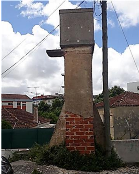
Figura 3. 19 - Reservatório de água elevado pertencente a moradia, estado inativo (Fonte: de autor) junho 2022.
