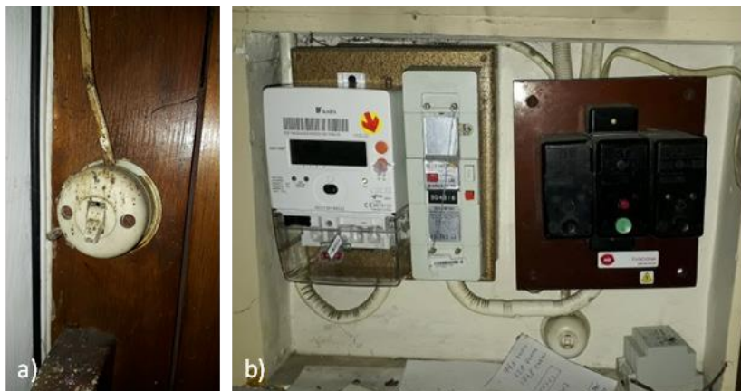
Figura 4.9 – Interruptores elétricos: a) Interruptor dos anos 50; b) Quadro elétrico atual ligado com acessórios antigos (Fonte: de autor), junho 2022.
