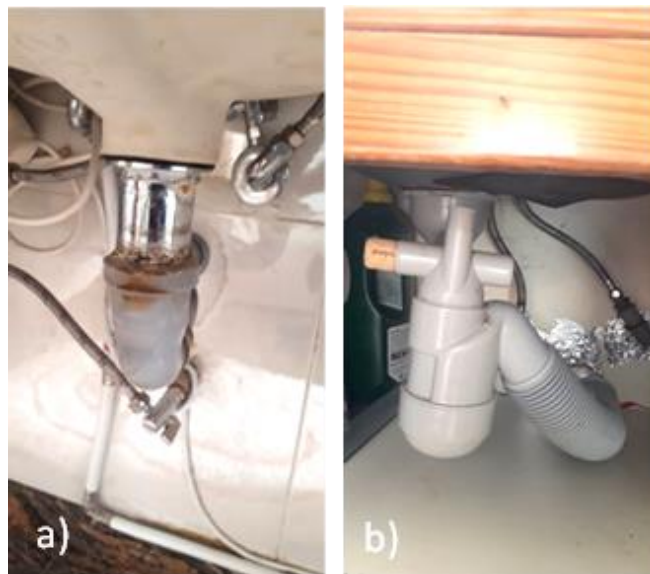
Figura 4.8 – Instalação de esgotos: a) Sifão do lavatório; b) Sifão do lava-loiça da cozinha (Fonte: de autor), junho 2022.
