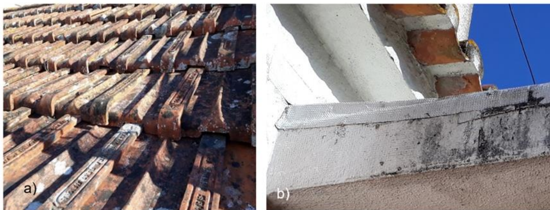
Figura 4.13 - Aspectos das anomalias da cobertura; a) Não encaixe das telhas; b) Remates improvisados com telas (Fonte: de autor), junho 2022.
